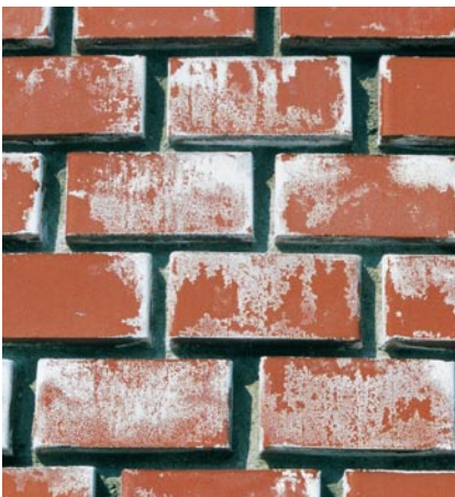
Sulfatausblühungen aus Sichtbausteinen
